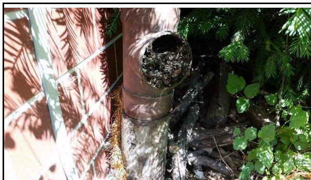
Fot. 39. Widok niedrożnej rewizji rury spustowej, wymagającej czyszczenia oraz nieprawidłowego zastosowania rury szarej, jako zewnętrznej rury odpływowej ułożonej w gruncie.
