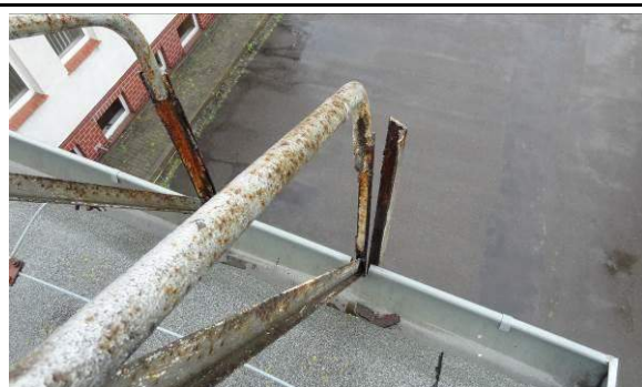
Fot. 21. Szczegół uszkodzonej drabiny zewnętrznej spowodowanej korozją.
