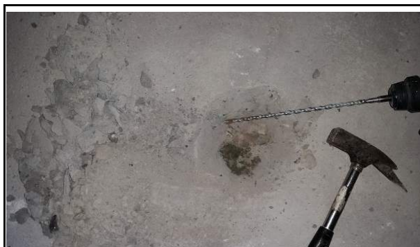
Fot. 69. Odkrywka posadzki na gruncie w piwnicy, wykazała w korytarzu izolację przeciwwilgociową z masy asfaltowej (bitumu).
