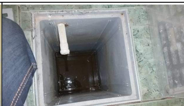
Fot. 48. Widok bezodpływowej studzienki w pomieszczeniu nr 0.11 w piwnicy.
