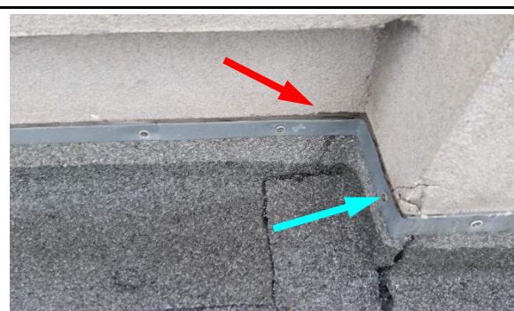
Fot. 13. Widok nietrwale wykonanej obróbki blacharskiej wokół kominów, na styku blachy z kominem widoczne zawilgocenie (czerwona strzałka), widoczne miejscowe wykruszenia tynku (strzałka niebieska).
