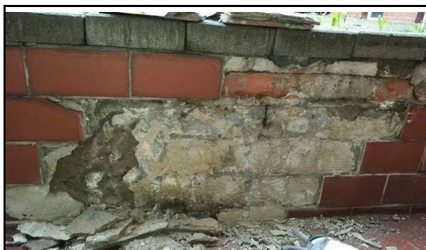
Fot. 67. Odkrywka murku naświetla piwnicznego, widoczny brak zastosowania izolacji przeciwwilgociowej.
