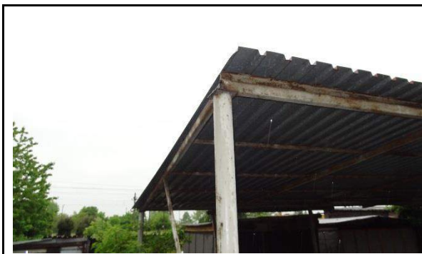
Fot. 23. Widok wiaty na podwórzu od strony południowej budynku, widoczne pokryte korozją powierzchnią elementy konstrukcyjne wiaty.
