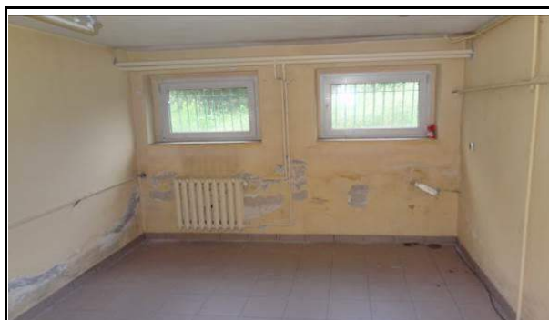
Fot. 49. Widok korozji biologicznej pomieszczenia piwnicy, widoczne wysolenia i ubytki tynku oraz powłoki malarskiej na powierzchni ścian.
