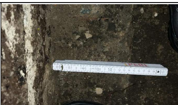
Fot. 46. Widok ławy fundamentowej w miejscu wykonania odkrywki oraz nieocieplonej ściany fundamentowej.
