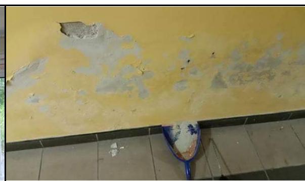
Fot. 62. Odwiert kontrolny ściany wewnętrznej piwnicy z bloczków betonowych, widoczne zawilgocenia i ubytku tynku.
