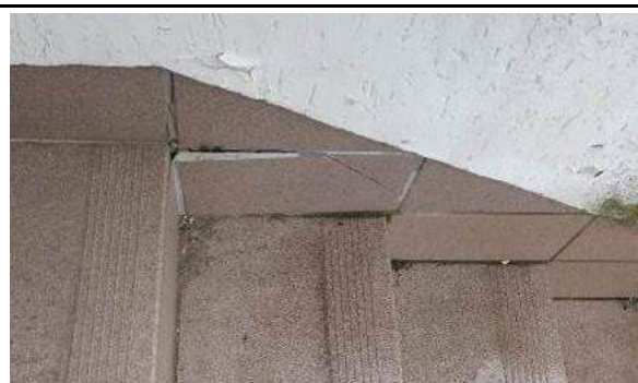
Fot. 29. Widok zewnętrznych schodów, istniejące płytki gresowe są popękane, część się wykruszyła, pomiędzy płytkami na fugach w wyniku długotrwałego zawilgocenia pojawiły się widoczne ślady grzybów.
