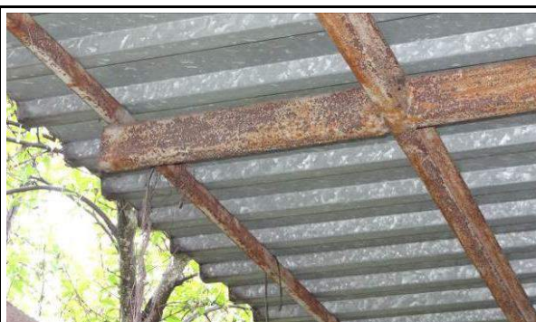
Fot. 24. Widok zniszczonych, powierzchniowo skorodowanych elementów konstrukcyjnych wiaty na posesji.
