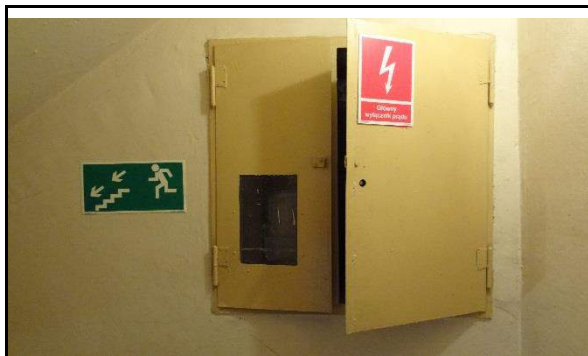
Fot. 87. Widok szafki głównej tablicy rozdzielczej budynku, zlokalizowanej na klatce schodowej prowadzącej do piwnicy
