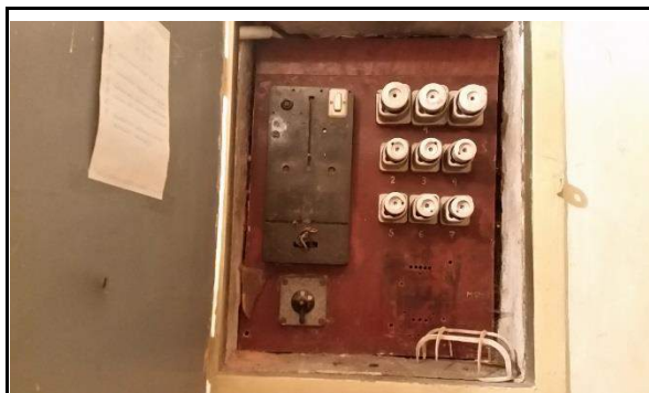
Fot. 89. Widok tablicy rozdzielczej pomieszczeń piwnicy z bezpiecznikami topikowymi starego typu do wymiany
