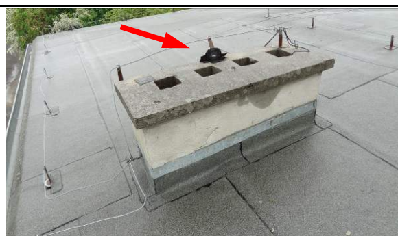
Fot. 11. Widok zacieków na kominie na styku połączenia z czapą betonową spowodowanych niewłaściwym wykonaniem czapy (brak kapinosów od spodu). Widoczne uszkodzone mocowanie instalacji odgromowej (czerwona strzałka).
