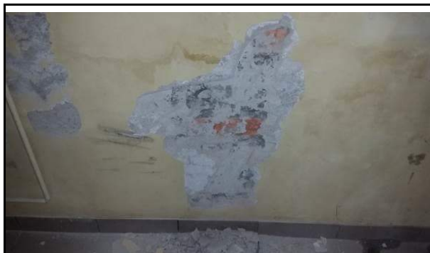
Fot. 63. Odkrywka ściany zewnętrznej piwnicy wykazała zastosowanie bloczków betonowych wraz z cegłą ceramiczną pełną.
