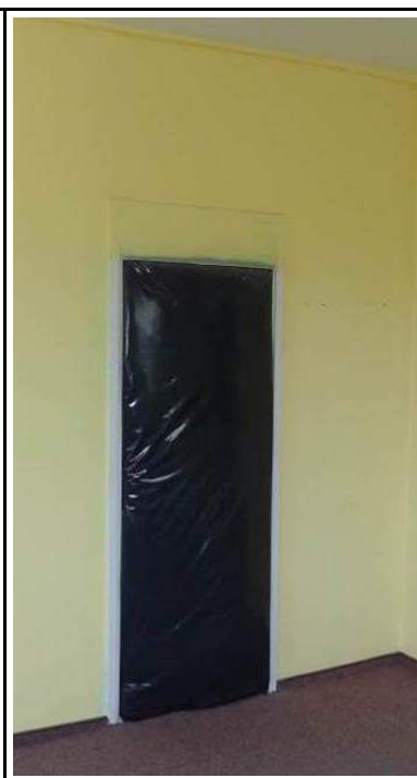
Fot. 84. Widok zaślepiętego otworu drzwiowego pomiędzy pomieszczeniami biurowymi na pierwszym piętrze.
