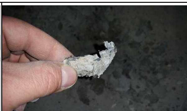
Fot. 70. Widoczny fragment izolacji przeciwwilgociowej z papy na osnowie tekturowej, wykonanej w pomieszczeniach nr 0.6, 0.7, zgodnie z wykonanymi odkrywkami.
