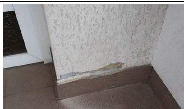
Fot. 30. Widok uszkodzonego fragmentu elewacji, część tynku się odspoła.
