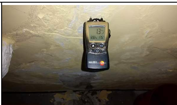
Fot. 66. Pomiar wilgotności ściany w pobliżu otworu okiennego przy naświetlu piwnicznym.
