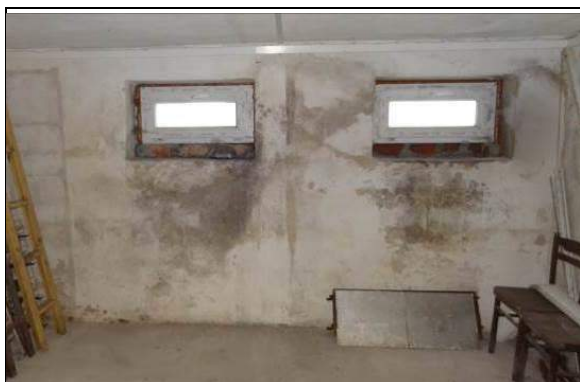
Fot. 57. Widok zaawansowanej korozji biologicznej zewnętrznych ścian piwnicy, widoczna wilgoć i wysolenia na powierzchni ściany, szczególnie poniżej otworów okiennych, spowodowana brakiem izolacji przeciwwilgociowej pionowej ścian i naświetli piwnicznych oraz wodą dostającą się do piwnicy.
