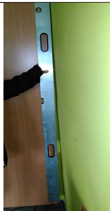
Fot.80. Widok odchyłki powierzchni ściany od pionu w części starszej budynku, przekraczającej wartość dopuszczalną.
