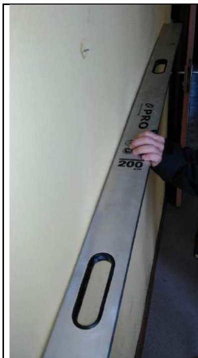
Fot. 82. Widok odchyłki powierzchni ściany w korytarzu w pomieszczeniu biurowym części dobudowywanej budynku, przekraczającej wartość dopuszczalną..
