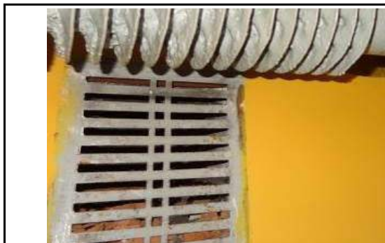
Fot. 53. Widok niedrożnego, zagruzowanego fragmentami cegły ceramicznej kanału wentylacji grawitacyjnej pomieszczenia piwnicy.
