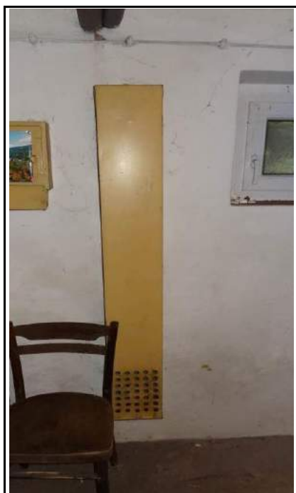
Fot. 104. Widok elementu nawiewnego wentylacji grawitacyjnej typu Z pomieszczenia piwnicy. Na powierzchni ściany widoczne zawilgocenie na styku z posadzką na gruncie.
