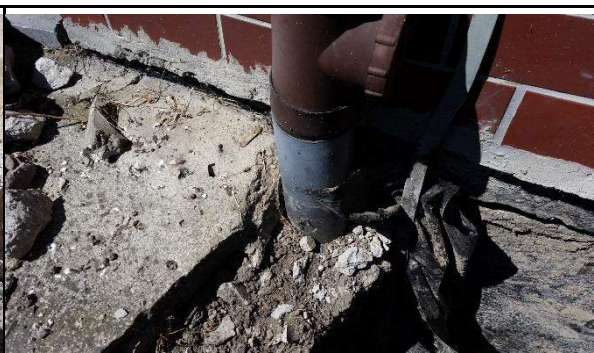
Fot. 38. Widok przyłączenia rury spustowej z rewizją do rury odpływowej szarej. Jest to nieprawidłowe rozwiązanie do kanalizacji zewnętrznej są przeznaczone rury PVC-U w kolorze pomarańczowym.
