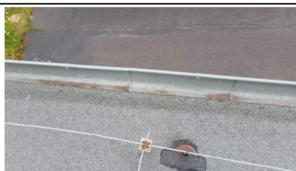
Fot. 10. Widok skorodowanej rynny oraz mocowania instalacji odgromowej
