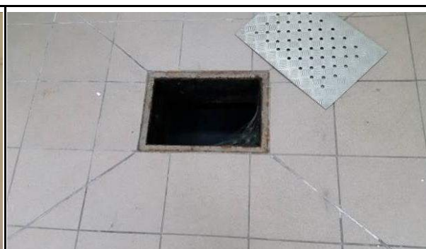
Fot. 50. Widok bezodpływowej studzienki umożliwiającej wypompowywanie wody z jednym z pomieszczeń piwnicy.
