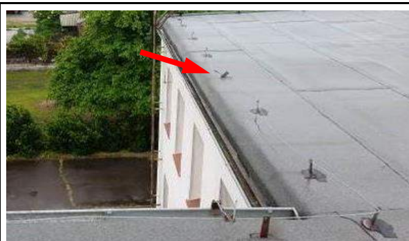
Fot. 22. Widok dachu, uszkodzony element mocujący instalację odgromową „odklejony” od powierzchni papy termozgrzewalnej (czerwona strzałka).
