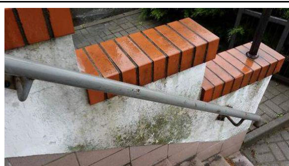
Fot. 27. Widok postępującej korozji biologicznej na murku ograniczającym schody wejściowe do budynku. Zielony nalot jest efektem długotrwałego zawilgocenia, świadczy o pojawieniu się na powierzchni grzybów.
