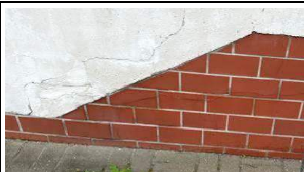
Fot. 28. Widok spękanego tynku na murze wzdłuż zewnętrznego biegu schodowego, na styku materiałów.
