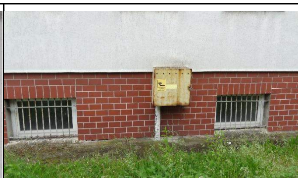
Fot. 96. Widok szafki na zewnętrznej ścianie budynku z gazomierzem i zaworem kulowym odcinającym gaz.
