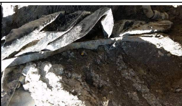
Fot. 44. Widok izolacji przeciwwilgociowej ścian fundamentowych z masy bitumicznej przykrytej folią PE
