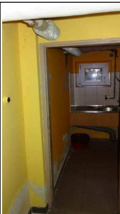
Fot. 102. Widok grzejnika stalowego rurowego przechodzącego przez ścianę wewnętrzną piwnicy. Na powierzchni ścian widoczna wilgoć do wysokości ok.40cm spowodowana podciąganiem kapilarnym.
