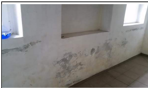
Fot. 55. Widok zamurowanego otworu okiennego w pomieszczeniu piwnicy, widoczne zacieki i wysolenia na powierzchni ściany.
