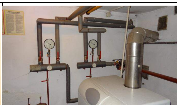
Fot. 90. Widok rozproszczenia instalacji w kotłowni.
