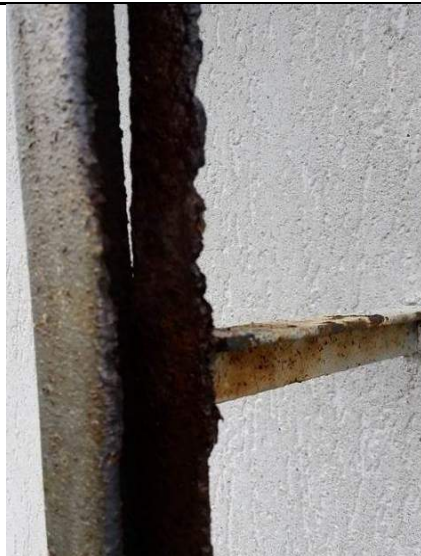
Fot. 20. Szczegół stalowego elementu pionowego drabiny, korozja w stanie bardzo zaawansowanym spowodowała rozwarstwienie się elementu.
