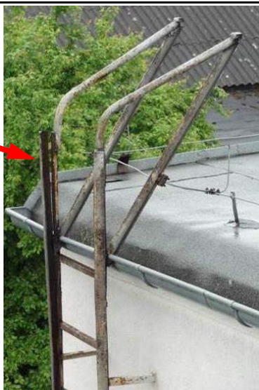
Fot. 19. Istniejąca stalowa drabina elewacyjna stanowiąca wejście na dach jest w znacznym stopniu skorodowana, część elementów uległa rozwarstwieniu (czerwona strzałka) nie spełnia obowiązujących przepisów BHP.
