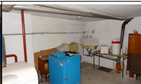
Fot. 92. Widok starego nieużywanego kotła gazowego typu Buderus w pomieszczeniu kotłowni
