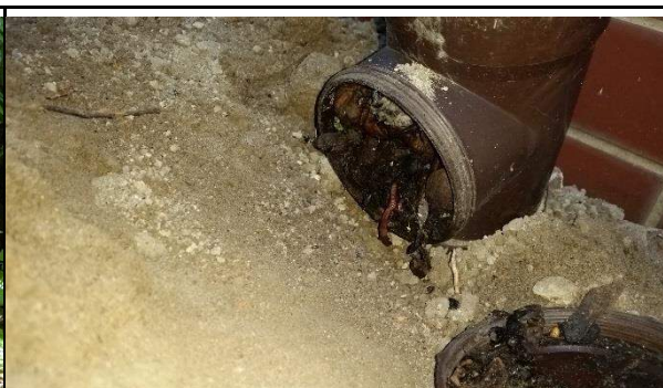
Fot. 40. Widok niedrożnej rewizji rury spustowej, wymagającej czyszczenia. Obecnie spływ wód opadowych do rur odpływowych jest niemożliwy.
