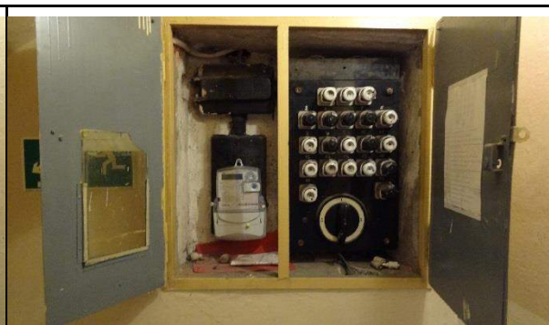
Fot. 88. Widok głównej tablicy rozdzielczej budynku z bezpiecznikami topikowymi starego typu i ręcznym wyłącznikiem głównym do wymiany
