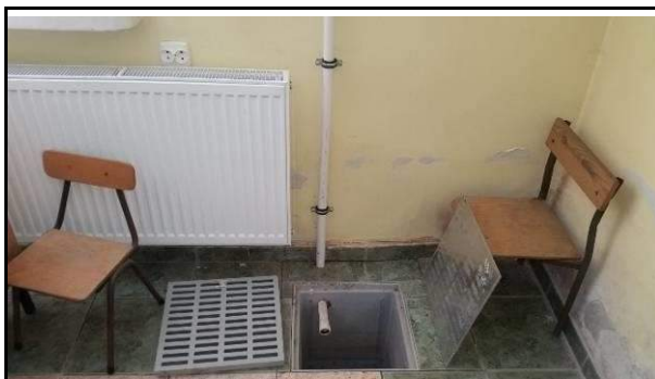
Fot. 47. Widok bezodpływowej studzienki umożliwiającej wypompowywanie wody z piwnicy w pomieszczeniu nr 0.11 wraz z rurą odprowadzającą wodę na zewnątrz budynku.
