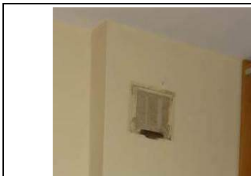
Fot. 85. Widok zaślepionego otworu przewodu wentylacyjnego w pomieszczeniu biurowym na pierwszym piętrze.
