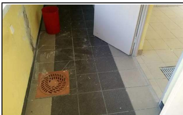
Fot. 51. Widok bezodpływowej studzienki umożliwiającej wypompowywanie wody z piwnicy na korytarzu (kolor pomarańczowy) połączonej ze studzienką bezodpływową w pomieszczeniu nr 0.9.
