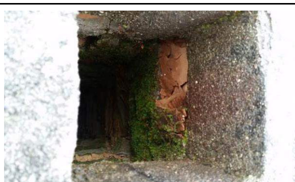
Fot. 16. Widok wnętrza zawilgoconego przewodu wentylacyjnego porośniętego mchem, widoczne miejscowe pęknięcia i odpryski cegieł spowodowane przemarzaniem.
