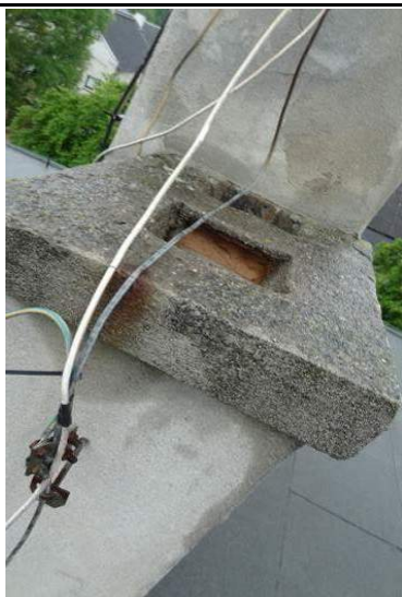
Fot. 17. Widok szczegółowy zacieków na styku z czapą betonową kominu.
