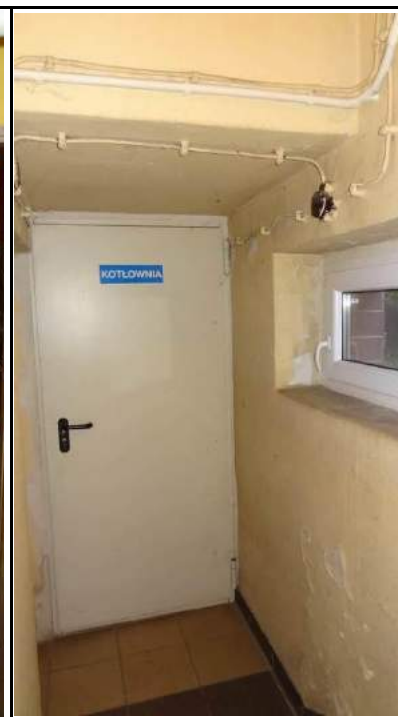
Fot. 103. Widok wejścia do kotłowni w piwnicy i instalacji elektrycznej natynkowej, widoczne nierówności oraz zniszczona, łuszcząca się powłoka malarska
