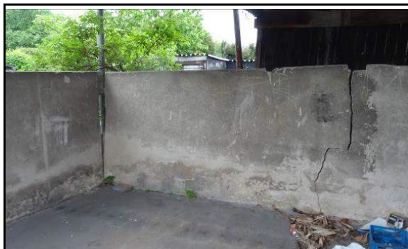
Fot. 31. Widok betonowego murku ograniczającego przestrzeń wiaty przeznaczoną na odpady. Widoczne pionowe pęknięcia muru, część muru się wykruszyła.
