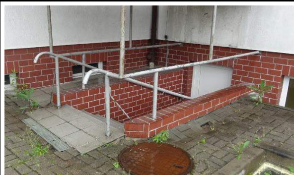
Fot. 26. Widok wejścia do piwnicy, wokół murku przy schodach i studzience kanalizacyjnej część płyt chodnikowych zapadła się, powodując brak odpowiedniego odprowadzenia wód opadowych, liczna roślinność pomiędzy płytami chodnikowymi.
