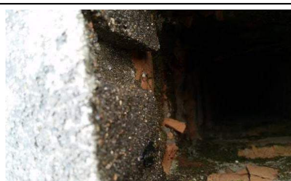
Fot. 15. Widok wnętrza zawilgoconego przewodu wentylacyjnego, widoczne miejscowe wykruszenia i odpryski kawałków cegieł, spowodowane przemarzaniem.
