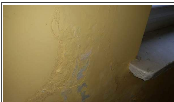
Fot. 65. Widok wysoleń na powierzchni ściany piwnicy w okolicy otworu okiennego, widoczne ubytki i nierówności spowodowane wilgocią.
