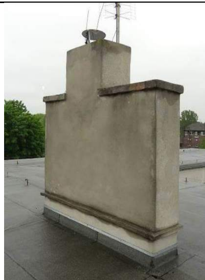
Fot. 18. Widok nadmurowanego kominu, widoczne zacieki wokół wystającej starej czapy betonowej oraz wokół wykonanej w późniejszym czasie czapy przykrywającej komin.
