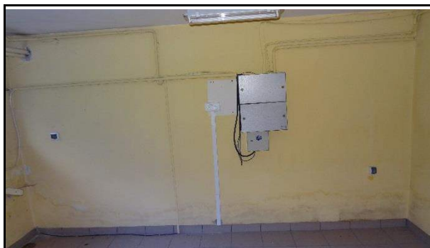
Fot. 97. Widok skrzynki przyłącza telekomunikacyjnego zainstalowanego w jednym z pomieszczeń piwnicy.
