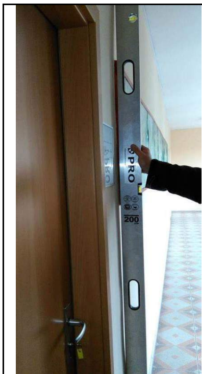
Fot. 79. Widok odchyłki powierzchni ściany od pionu w korytarzu w części dobudowywanej budynku, przekraczającej wartość dopuszczalną.
