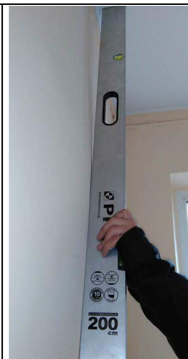
Fot. 81. Widok odchyłki powierzchni ściany od pionu w pomieszczeniu biurowym w części dobudowywanej budynku, przekraczającej wartość dopuszczalną..
