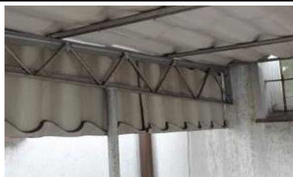
Fot. 25. Widok miejscowej korozji powierzchniowej skorodowanego stalowego zadaszenia nad wejściem do piwnicy.
