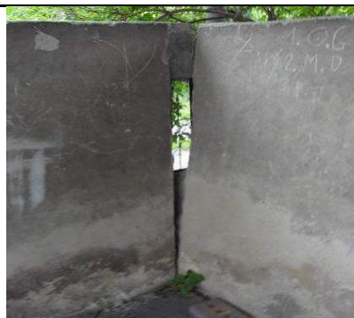
Fot. 32. Widok uszkodzonego muru betonowego, część muru „rozeszła się” przez nierównomierne osiadanie, brak prawidłowego wiązania w narożu.
