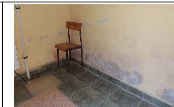
Fot. 54. Widoczne zawilgocenia ścian na styku z posadzką na gruncie oraz ubytki tynku.
