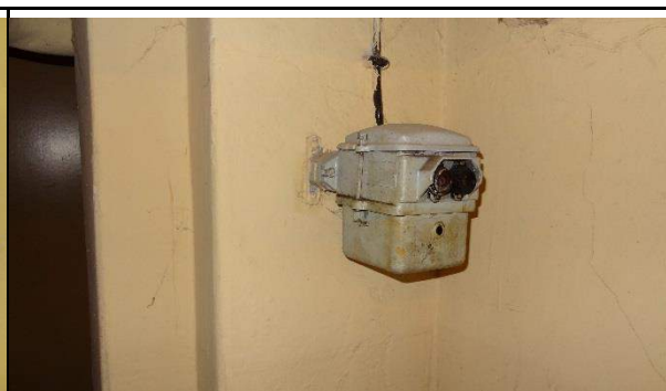
Fot. 94. Widok wyłącznika starego typu w pomieszczeniu piwnicy.
