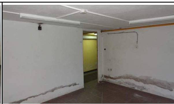
Fot. 56. Widok zawilgoconych ścian wewnętrznych piwnicy do poziomu ok. 40cm.
