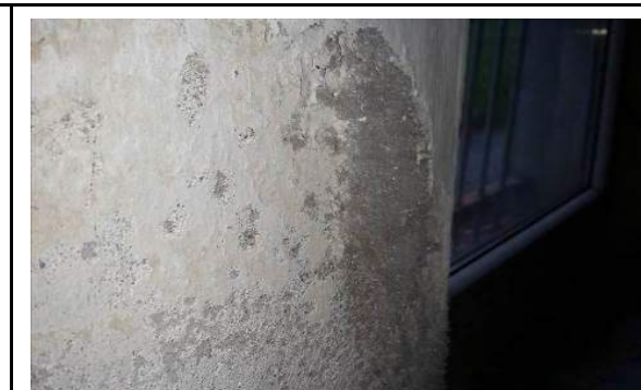
Fot. 60. Widok grzyba domowego białego na powierzchni ścian w pomieszczeniach piwnicy.
