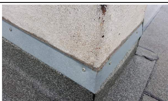
Fot. 14. Widok nietrwale wykonanej obróbki blacharskiej wokół kominów, na styku blachy z kominem widoczne zawilgocenie.
