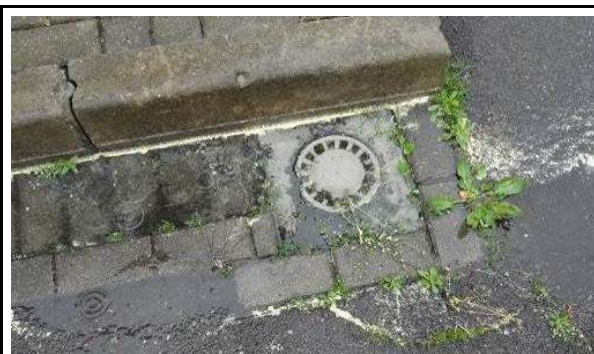
Fot. 36. Widok niedrożnego, porośniętego mchami wpustu podwórzowego odprowadzające wody opadowe z terenu posesji.
