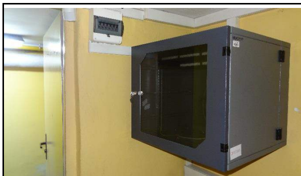
Fot. 93. Widok szafki z doprowadzonymi przewodami instalacji logicznej w listwach na tynku.
