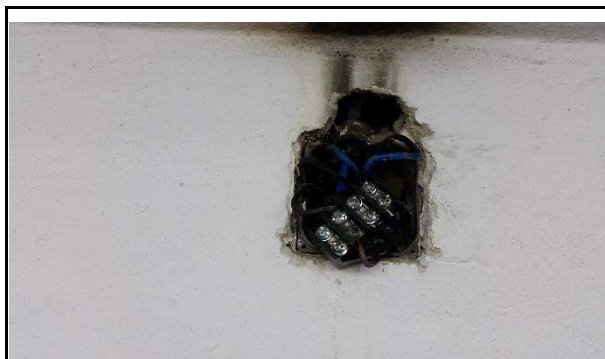
Fot. 95. Stara instalacja elektryczna aluminiowa do wymiany
