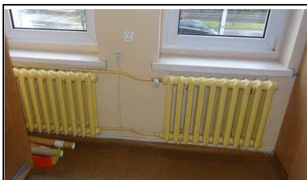
Fot. 99. Widok grzejników żeliwnych wymagających wymiany z uwagi na swój stan techniczny.
