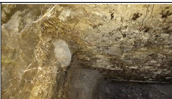
Fot. 42. Widok ściany i ławy fundamentowej, widoczny gruz w piasku użyty przy zasypywaniu wykopu.
