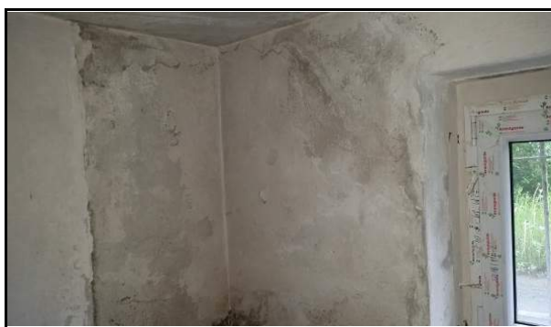
Fot. 61. Widok korozji biologicznej, widoczny grzyb biały domowy na powierzchni ścian, widoczna nieusunięta folia ochronna na ramie okiennej.
