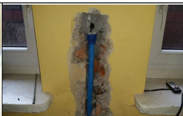
Fot. 52. Widok nieprawidłowo wykonanej rury odprowadzającej wodę ze studzienki, osadzonej w brudzie bez tulei osłonowej za pomocą zaprawy uniemożliwiającej pracę rozszerzalnego materiału.
