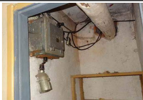
Fot. 86. Widok uszkodzonej rury instalacji c.o. w piwnicy, widoczna wykruszona masa gipsowa, nieuszczelnione przejście rury przez ścianę.
