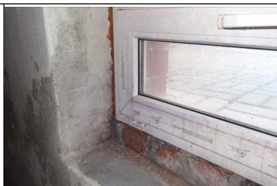
Fot. 58. Widok zawilgoconej powierzchni ściany piwnicy wokół otworu okiennego, spowodowanej brakiem izolacji przeciwwilgociowej pionowej ścian i naświetli piwnicznych. Widoczne zacieki i brak tynku na powierzchni ścian
